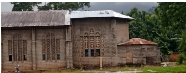
Primer plano del tejado terminado. La zona corta de la derecha con el tejado oxidado es la Sacristía.
